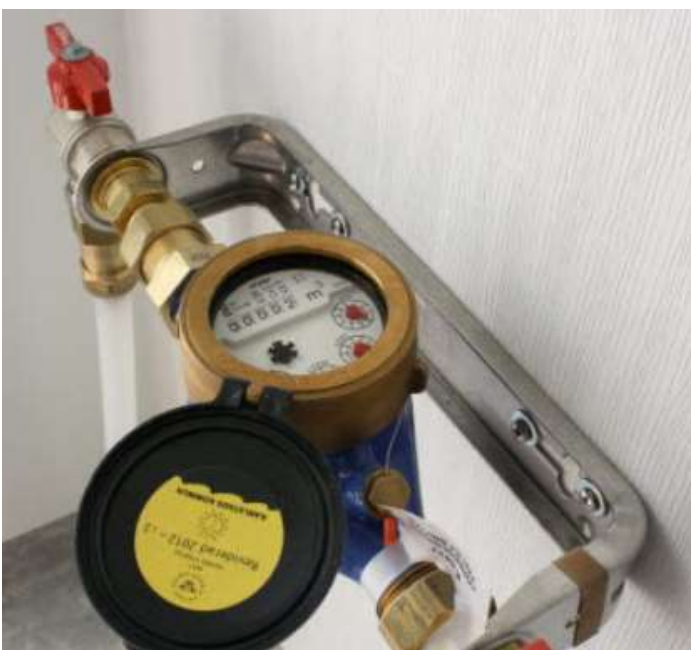
Figur 4- vattenmätare med konsol
